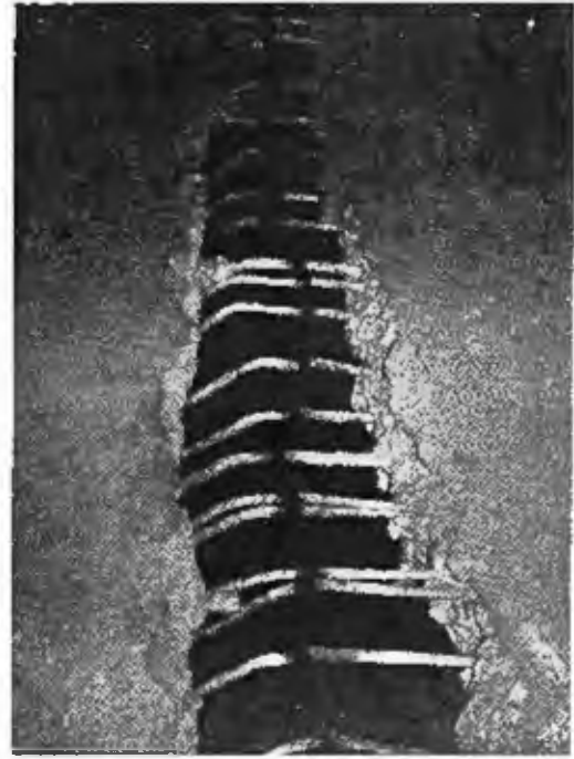
Fig. 17.25 - Ferri del cemento armato di un solaio tagliati lungo il piano verticale mediano trasversale dell'edificio di fig. 17.24 (Nobel Hefte)
